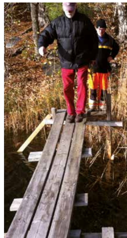
Bavariabryggan NV spång. Vi funderar på att byta ut den!
