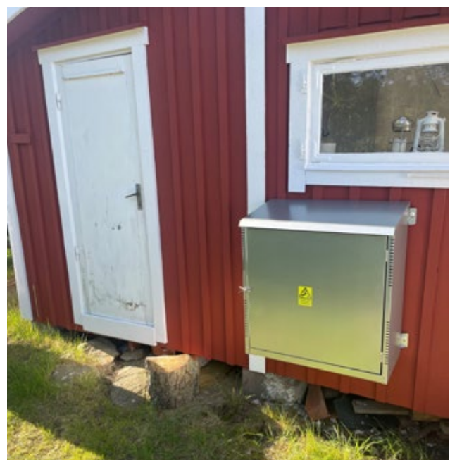
Ny placering och nytt skåp för 2 gasolruber till vår stuga på Kälö
